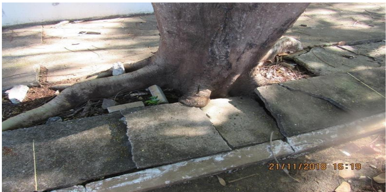
Figura 29 - Calçada irregular danificado pelas raízes
